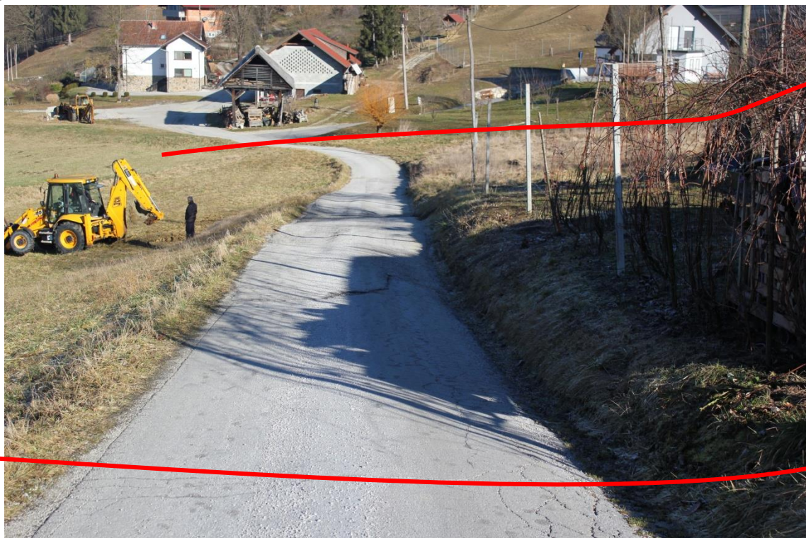
Poškodbe so v območju ceste v dolžini 70m
